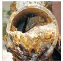
Taponamiento de tubería con grasas y aceites.
